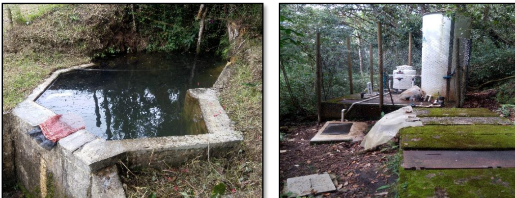
Figura 8. Área de captación y tanque de almacenamiento del acueducto Santa Teresa.
