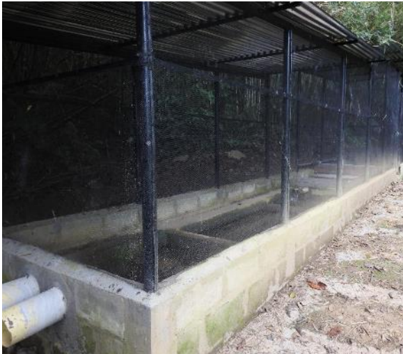
Fotografía 5. Sistema de derivación y desarenado del acueducto del Centro de Investigación El Nus
