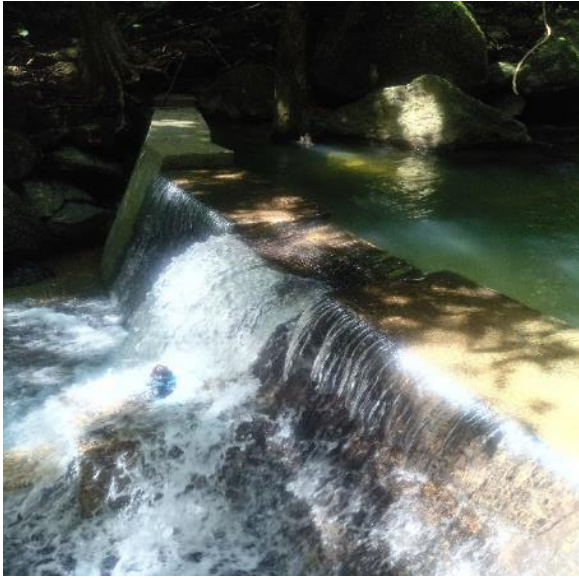
Fotografía 3. Dique de captación con rejilla de fondo sobre la quebrada La Chica
