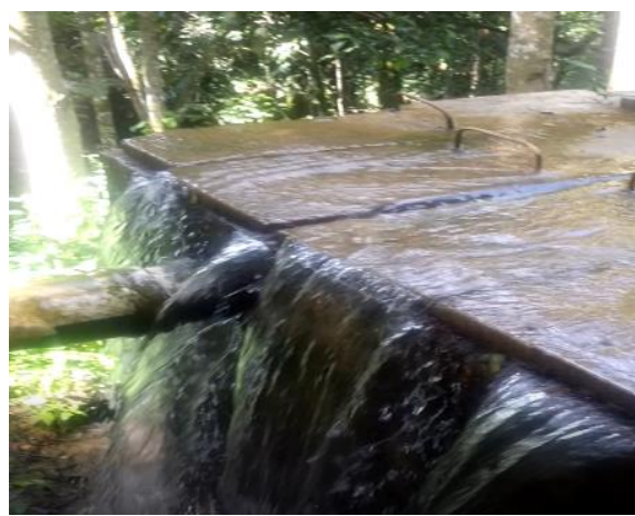
Fotografía 2. Rebose en estructura de desarenado
