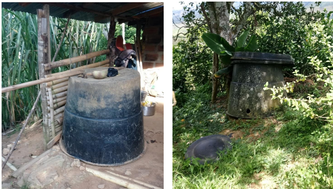
Fotografía 56. Tanques de pozos sépticos en desuso por deficiencias en la instalación del sistema
